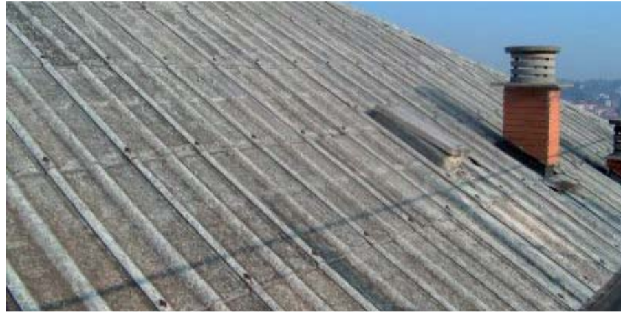
Un tetto in amianto, come ce ne sono ancora tanti
